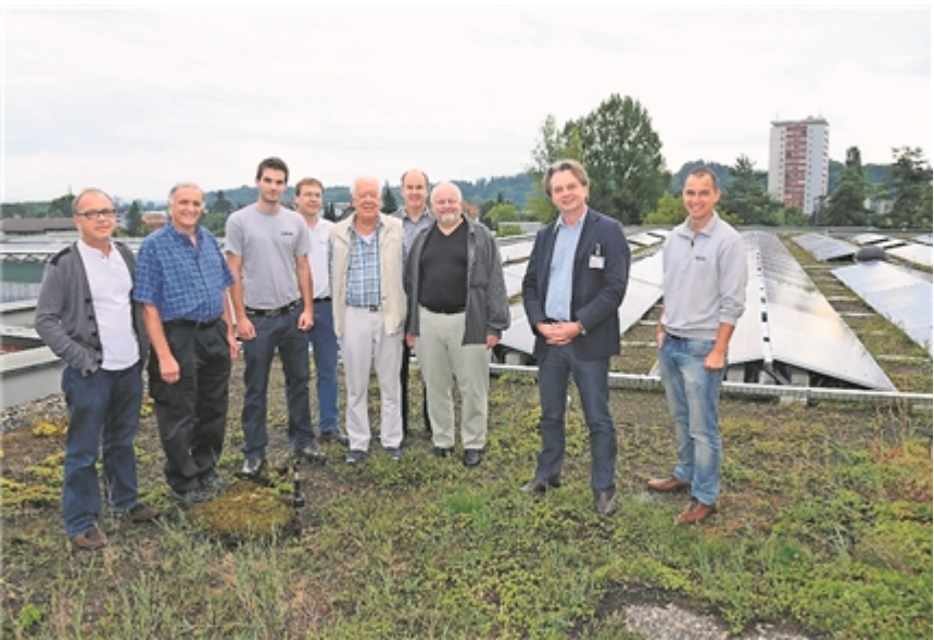
Die Solaranlage auf dem Flachdach.
